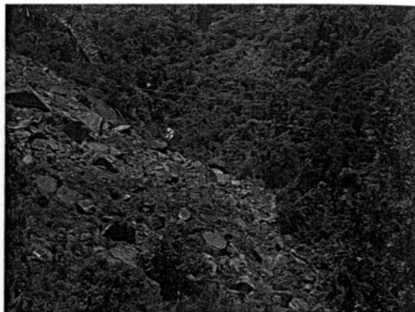
照片三、滑動面東北側之邊坡破壞
