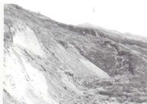
圖 4 深層滑動的上邊坡(由照片左向右滑動，移動約 25~30m)
