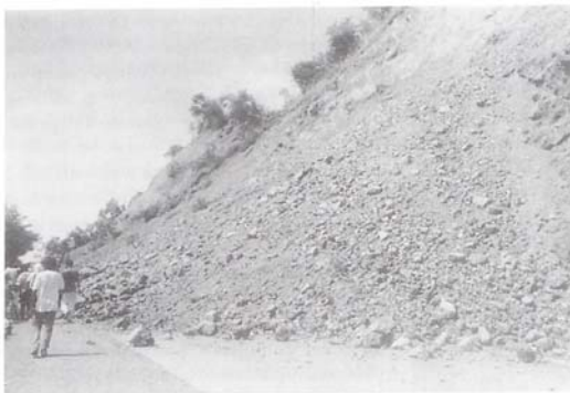
圖 7 坡面落石(沿著高速公路旁邊)
