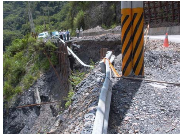
圖 16 道路下邊坡流失
