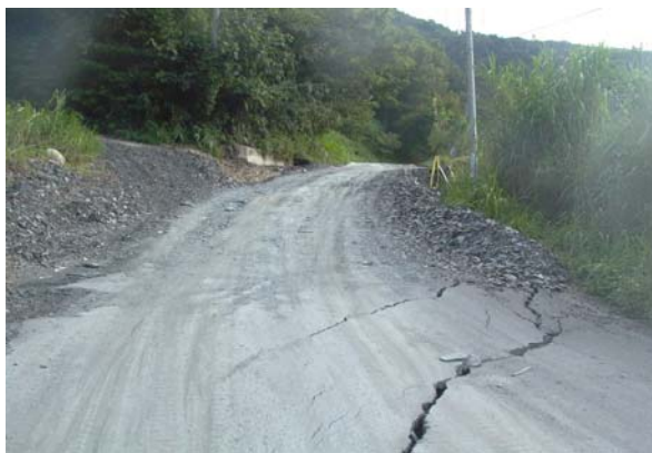
圖 25 投 85 線 16k 附近的道路損壞
