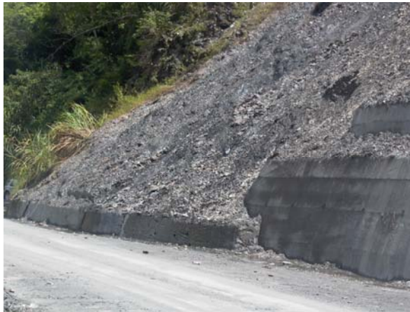
圖 15 路旁上邊坡擋土牆受推移損毀
