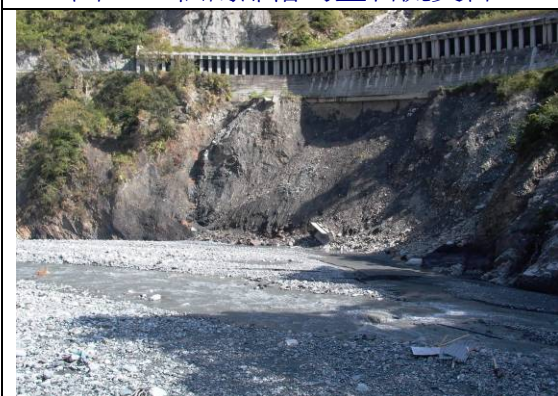
圖 55 谷關往上谷關的明隧道下邊坡崩塌嚴重
