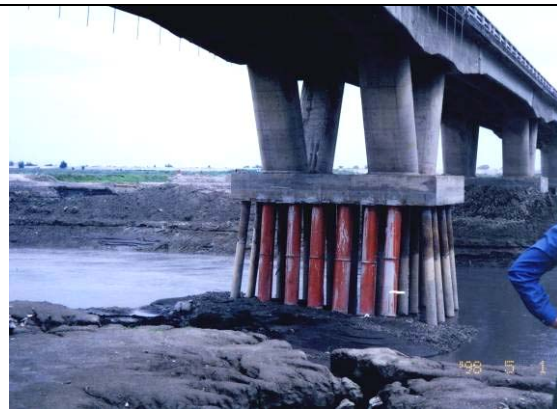
圖 47 濁水溪下游中沙大橋裸露的橋墩
