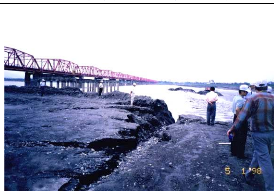
圖 48 濁水溪下游西螺大橋河岸的切蝕
