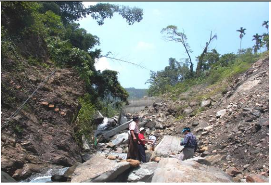
圖 9 米蘿坑溪上游土石崩落
