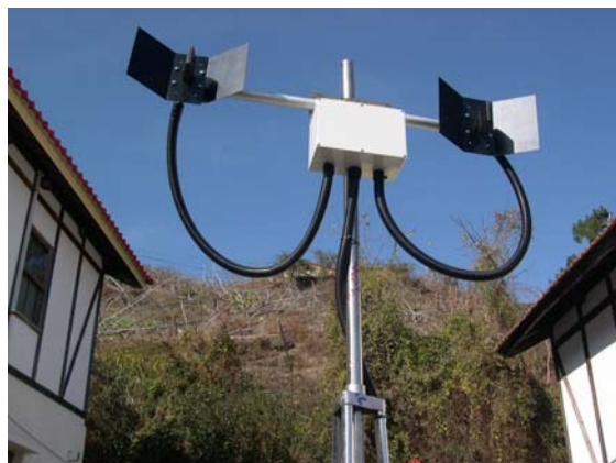
圖 3-16 現場天線裝設照片
