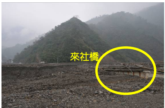
圖 11 來社橋遭土石掩蓋(莫拉克風災後)
