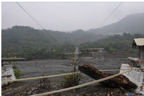
圖 17 泰義大橋損毀(莫拉克風災後)
